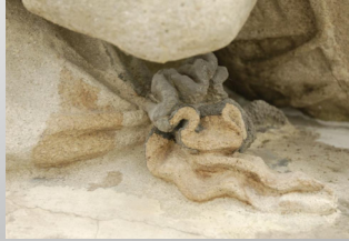
Croûte noire de la bourse, microablavage. © C. Brière
