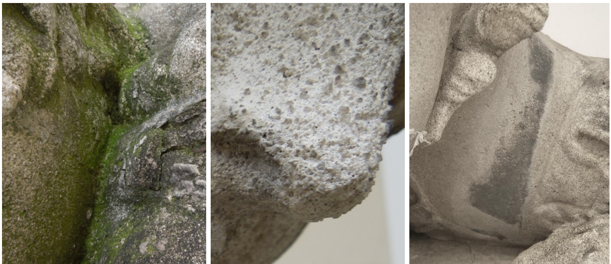
Figure 15 : Colonisation biologique des épaules et de la collerette de plumes.
