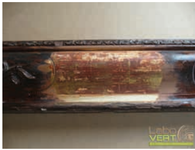
© Felbermair-Ecstra Dégagement de peinture, faux bois.
